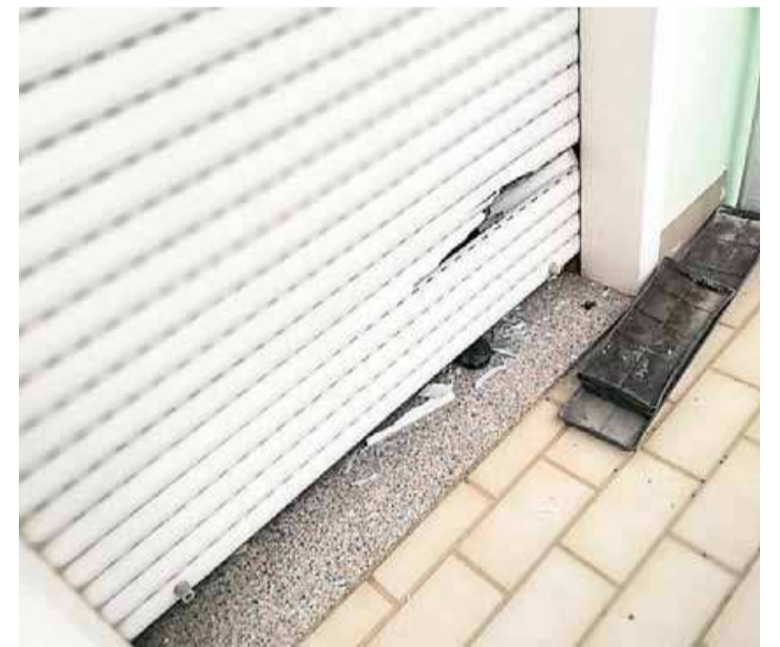
Altri danni sul terrazzo dell'abitazione arcense
