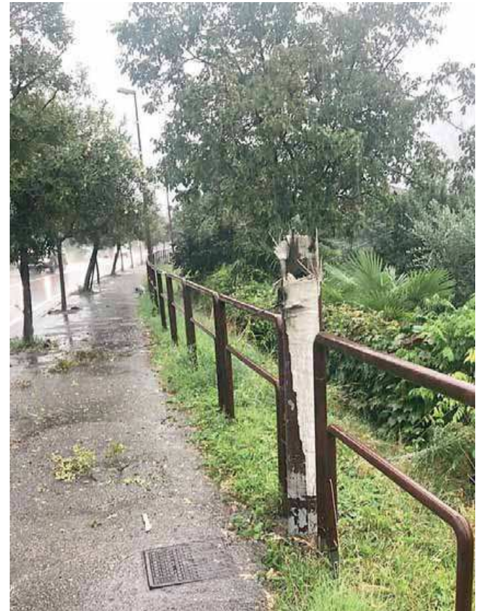
Il lampione sul marciapiede della 45 bis appena colpito dal fulmine
