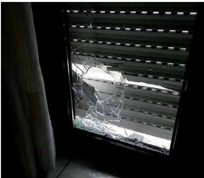
La finestra della casa centrata in pieno dopo l'esplosione
